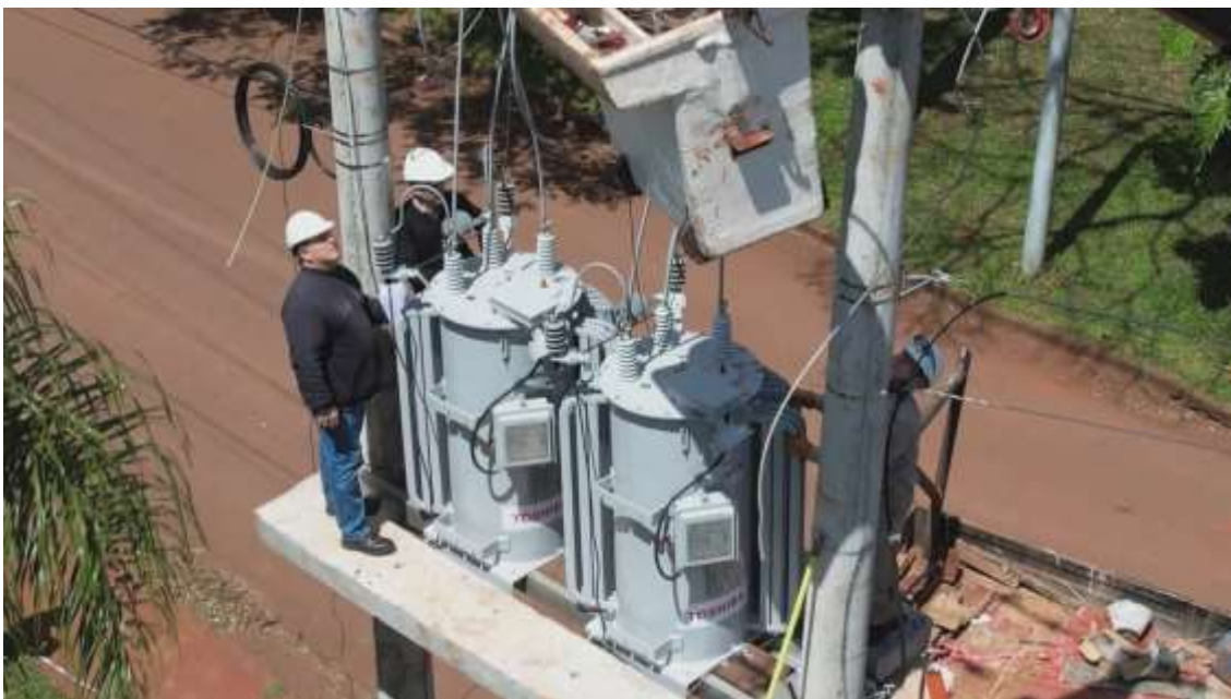
Reguladores de Tensión instalados en alimentador troncal de Av. Brasil
