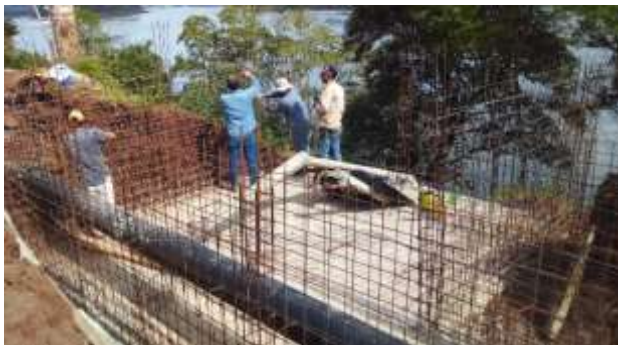
Instalación de caños camisa de acero para nueva Toma de Agua en Río Paraná.
