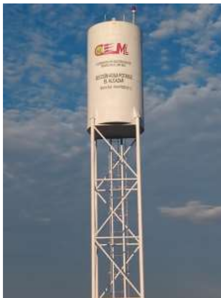
Tanque elevado de 10.000 litros, en Pozo Nº 13 – El Alcázar
