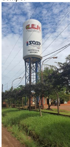
Imagen de nuevo tanque elevado en Planta de Tratamiento.
