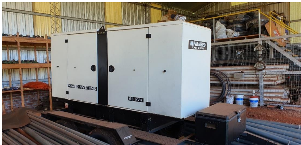
Imagen de grupo electrógeno montado en un tráiler.
