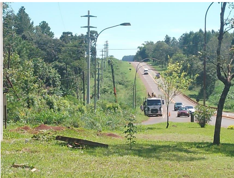
Imagen de estructuras de H º A º montadas para nueva línea de 33 kV .
